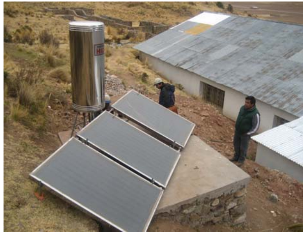
Instalación terma solar para calefacción y agua caliente
